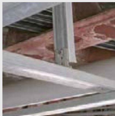
عدم اجرای جزئیات آویزگیری
