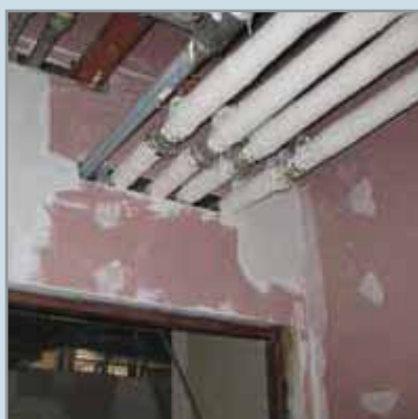
عدم رعایت الزامات کد حریق
