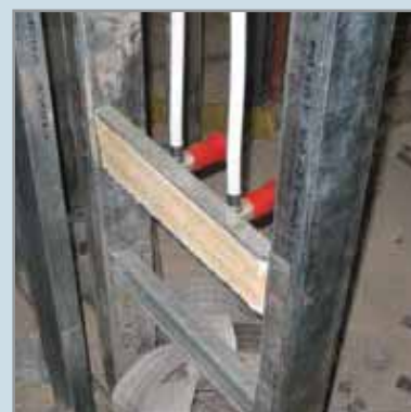
عدم اجرای صحیح جزئیات روشویی
